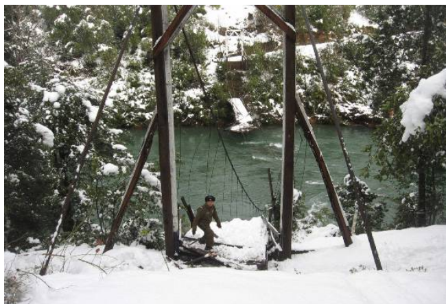
Figura 39. Caída de pasarela en paso El León 2012 (Municipalidad de Cochamó 2013).
